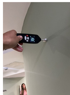
A fal állapota a károsodott szakasz felett
